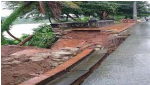
ຮູບພາບ 21: ຕາຝັ່ງແຄມນ້ຳຄານ ໄດ້ຮັບຄວາມເສຍ ຫາຍ, ນະຄອນ ຫວງພະບາງ, ແຂວງຫວງພະບາງ. ທີ່ ມາຂອງຮູບ: ສະເຫວີຍ ສີລາວັນ.
