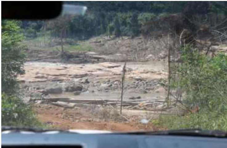
ຮູບພາບ 27: ເສັ້ນທາງໄປ ນ້ຳຕົກເຊບ່ອງໄລ. ສະແດງໃຫ້ເຫັນເຖິງ ເສັ້ນທາງທີ່ໄດ້ຮັບຄວາມເສຍຫາຍ ໃນ ເຂດສຳປະທານ. ເມືອງສະໜາມໄຊ ແຂວງອັດຕະປື. ທີ່ມາຂອງຮູບ: ແສງອາລຸນ ທອງສະຫວັດ
