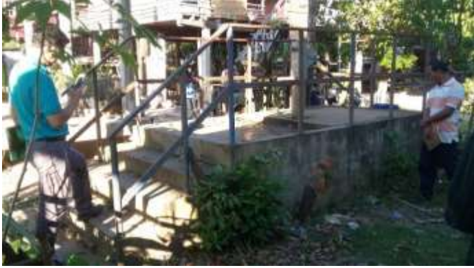
ຮູບພາບ 44: ລະບົບນໍ້າລົນ ໄດ້ຮັບຄວາມ ເສຍຫາຍຈາກນໍ້າຖ້ວມ ໃນແຂວງຊຽງຂວາງ. ທີ່ມາຂອງຮູບ: ທີມງານປະເມີນຜົນ.
